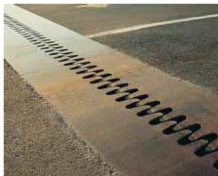
Figura 4.5 – Foto mostrando as juntas de expansão que há numa ponte para prevenir o surgimento de tensões térmicas.
